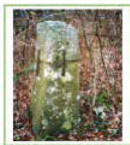
N° 81 Parcelle 462 Réparée avec des grilles en fer
